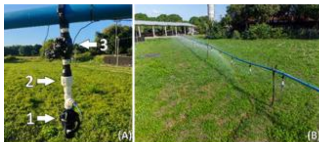
Figura 2 – (A) Detalhamento dos pendurais de aspersores; (B) Vista em perspectiva do sistema irrigando
