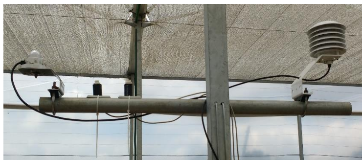
Figura 5. Sensores de radiação solar, temperatura e umidade do ar instalados no centro da área experimental.
